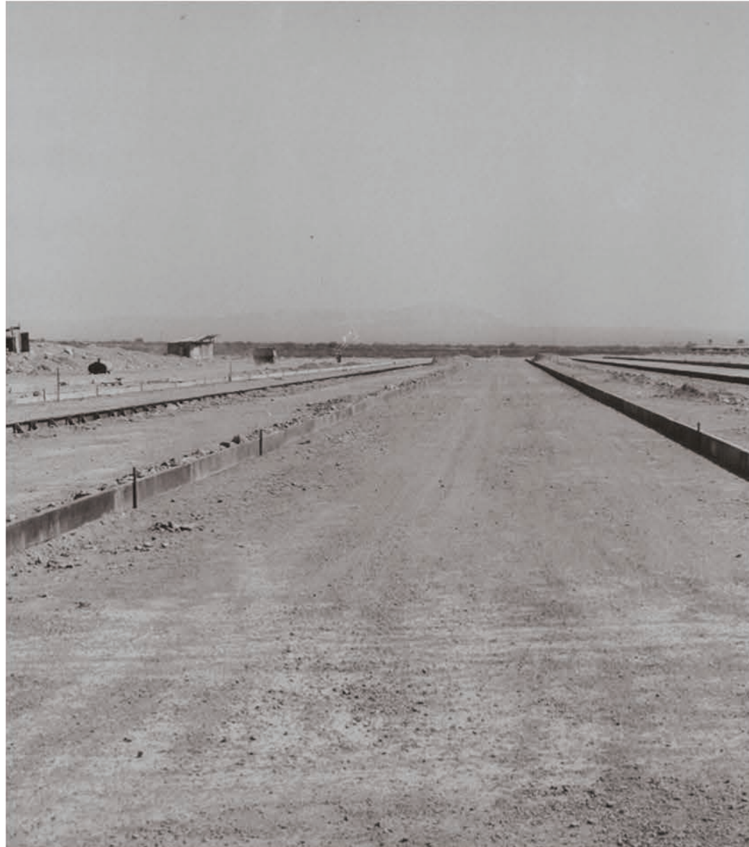
Fig. 60. Mendoza Aeroparque, view of runway construction, 1964. Aeroparque Mendoza, pista de aterrizaje durante el periodo de construcción, 1964.
