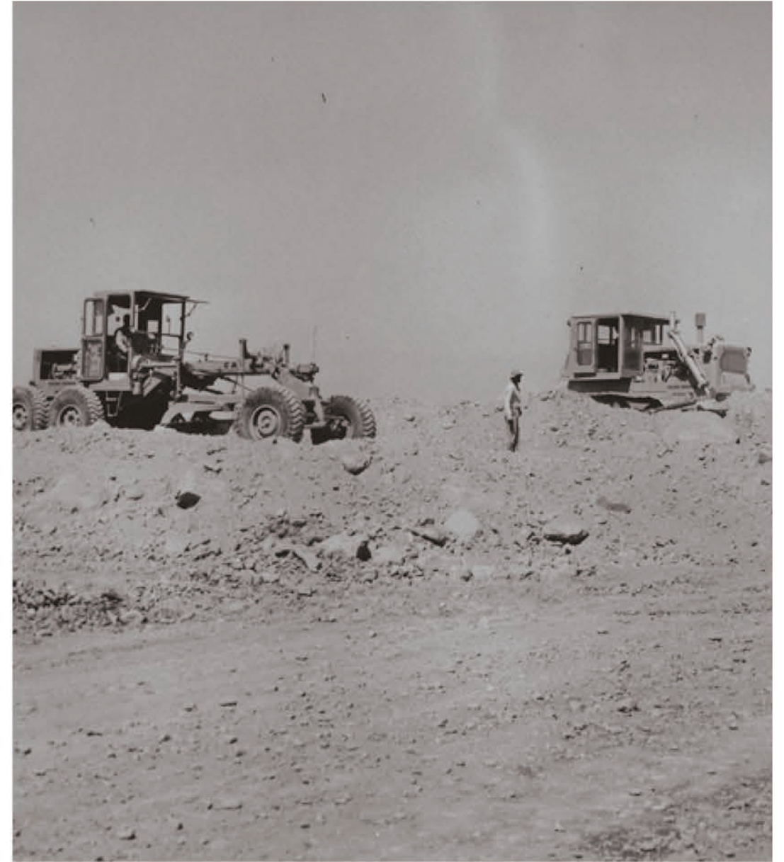
Fig. 61. Mendoza Aeroparque, view of machinery on site during runway construction, 1964. Aeroparque Mendoza, maquinaria en sitio durante el periodo de construcción, 1964.
